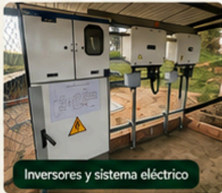
Vista general de la Granja Solar Fotovoltaica
